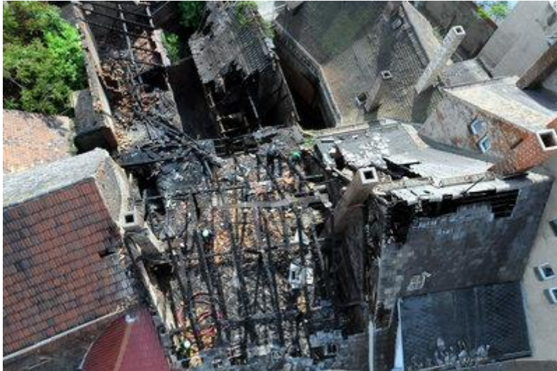
Sicht von oben auf das Wohnhaus, welches am Mittwochabend in Weißenfels ausgebrannt ist. (FOTO: PETER LISKER)
