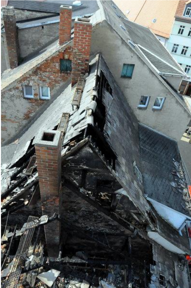
Der abgebrannte Dachstuhl des Wohnhauses in Weißenfels. Die Flammen griffen schnell auf den Dachstuhl über und breiteten sich auf das Hauptgebäude aus. Ein Übergreifen des Brandes auf das Nachbargebäude konnte von der Feuerwehr verhindert werden. (FOTO: PETER LISKER)
